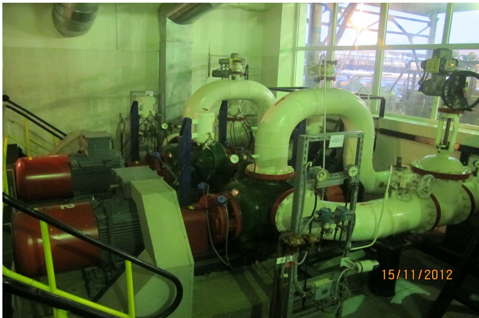
Внешний вид мощных двухвинтовых насосов Allweiler-Houttuin перегрузки нефти и мазута в насосной РН-АНП (г. Архангельск)
